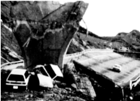
Figura 20. Colapso de un viaducto en Northridge, C.A., 1994
