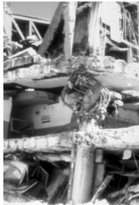
Figura 16. Colapso de un edificio de concreto reforzado causado por el sismo del 19 de septiembre de 1985, en la Ciudad de México
