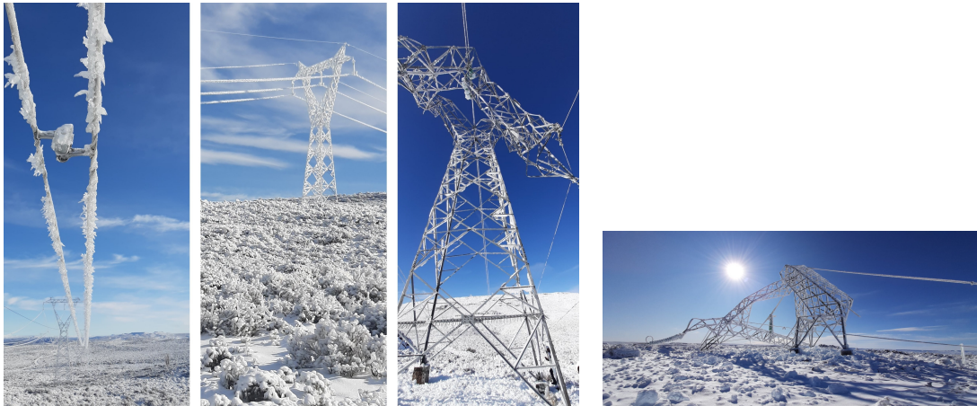
Figura 13.18: Destrucción de tendidos y torres de alta tensión por galopeo en Chubut, Argentina en 2021.
